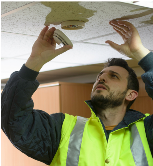
Le détecteur de fumée est un équipement indispensable.
